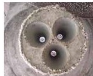
Внутри устройство чистое и полностью функционирующие.
